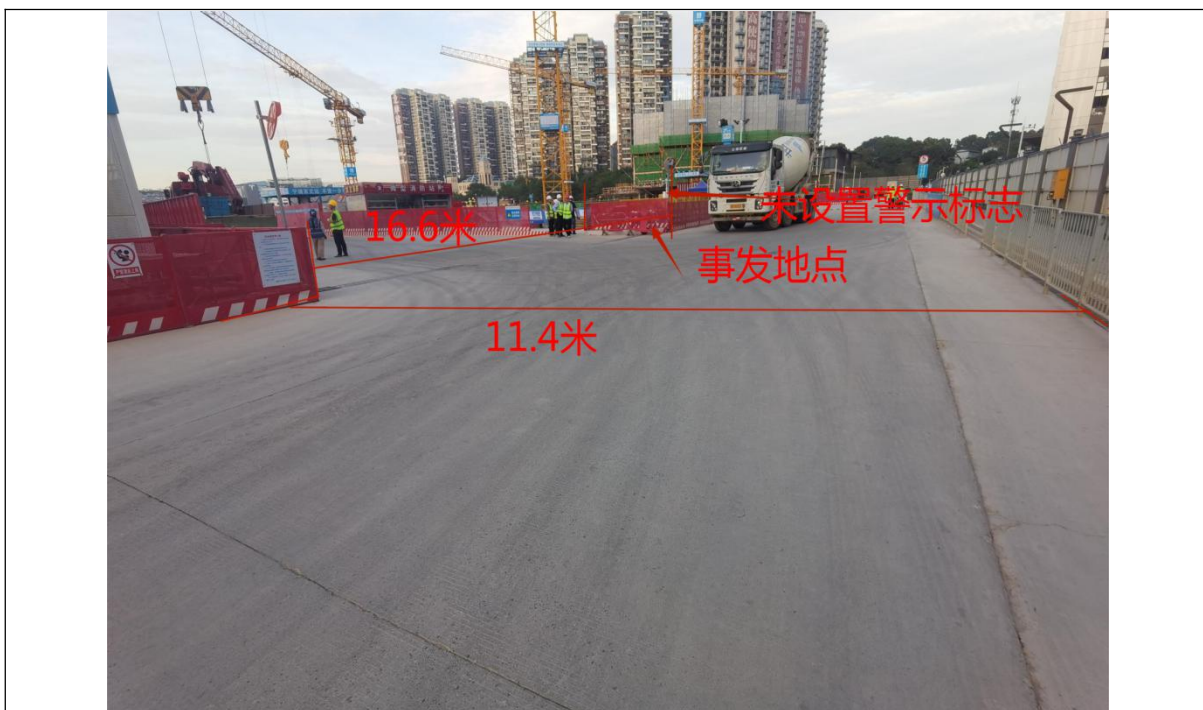
图 2 事故发生作业点
